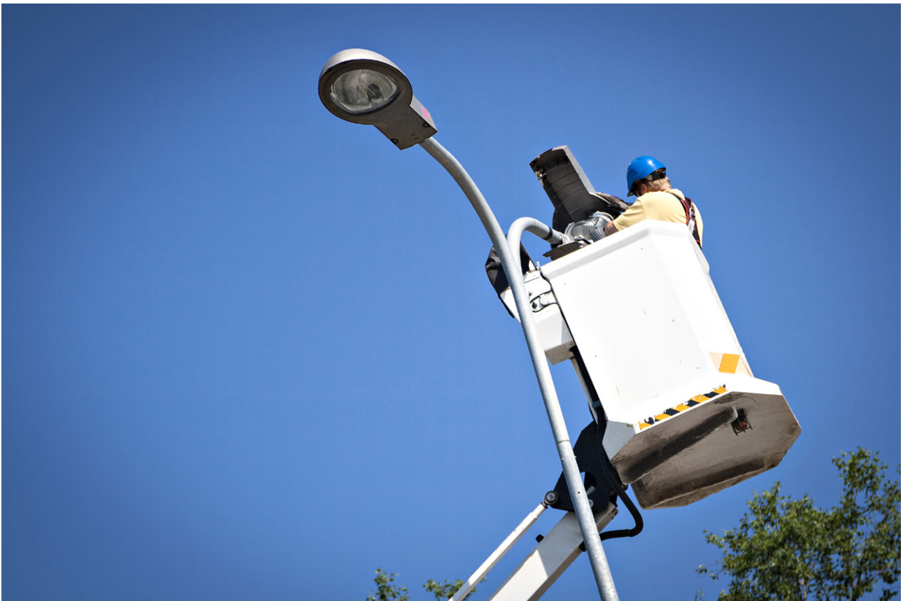
Kuva 42. Tievalaisimen huoltoa Ruskeasannassa. Kuva Vantaan kaupunki.
